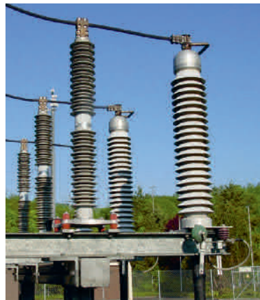
Messa a terra da un'estremità della guaina del cavo sui terminali isolati in aria
