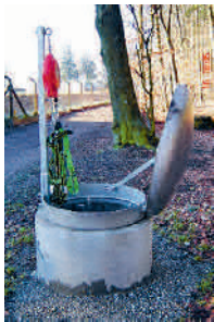
Fossa con assicurazione anticaduta
