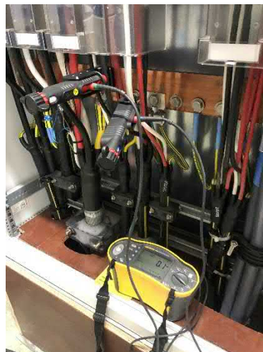
Controllo delle fasi La tensione deve indicare 0 Volt
